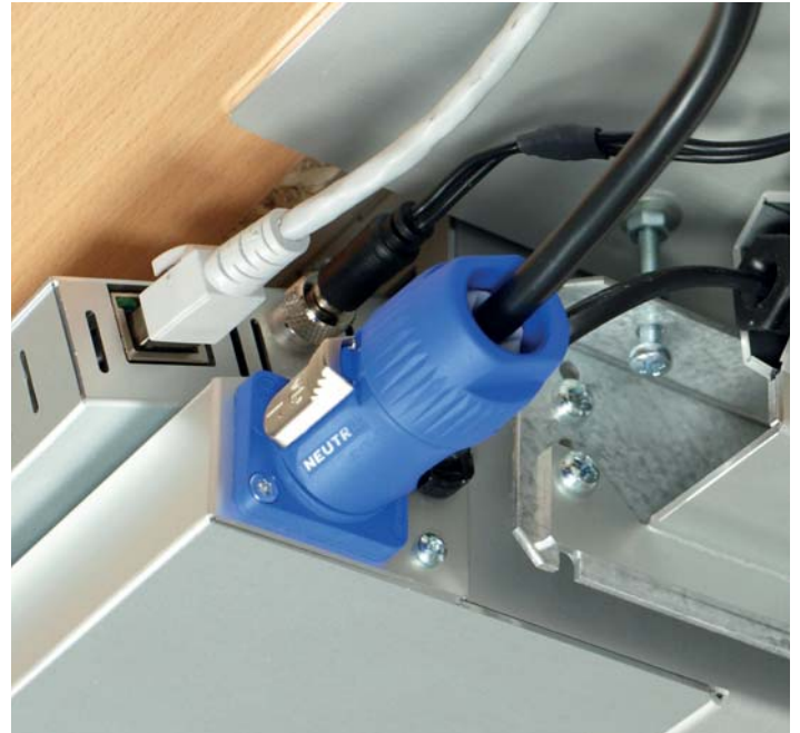
Hier sehen Sie alle benötigten Anschlüsse von Anschlussfeld zu Anschlussfeld.
